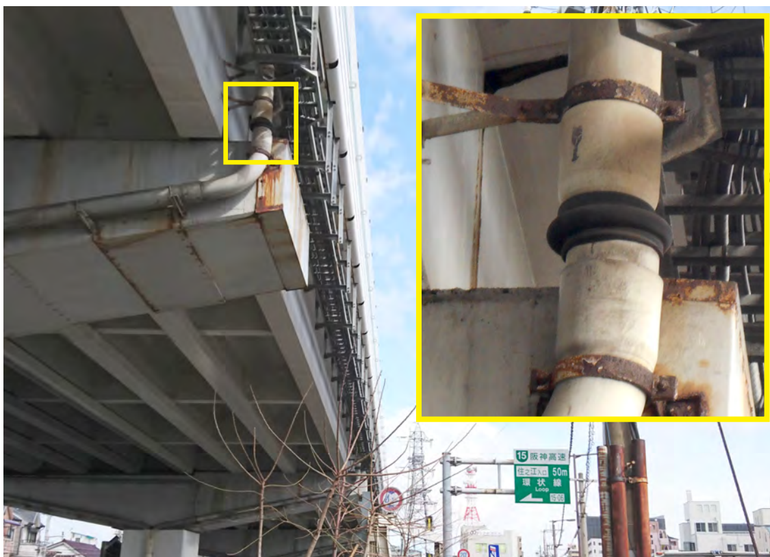
昭和 54 年（1979 年）に阪神高速道路 15 号堺線に取り付けられた「 \phi 200A 型」です。阪神大震災を経た現在でも完全な機能を維持しています。 (2017 年 1 月撮影)
